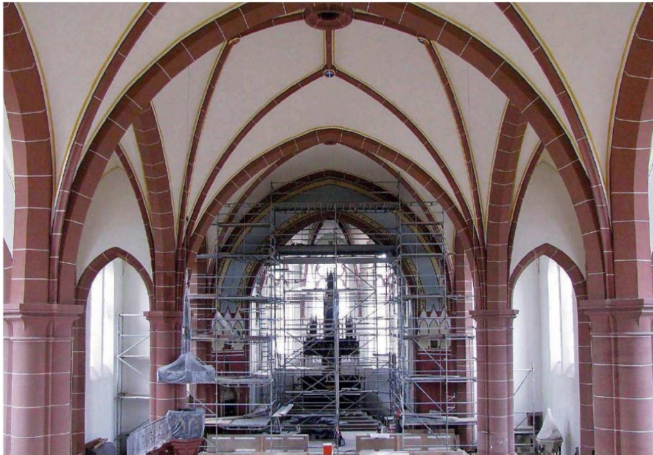
Das Parkett im Inneren der Kirche ist verlegt. Aber die Restauratoren sind noch mit Malerarbeiten beschäftigt. FOTOS: PLANUNGSBÜRO MICHAELI (8)
